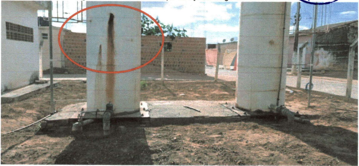
Figura 3. Corrosão na chapa de aço ao longo do reservatório.
